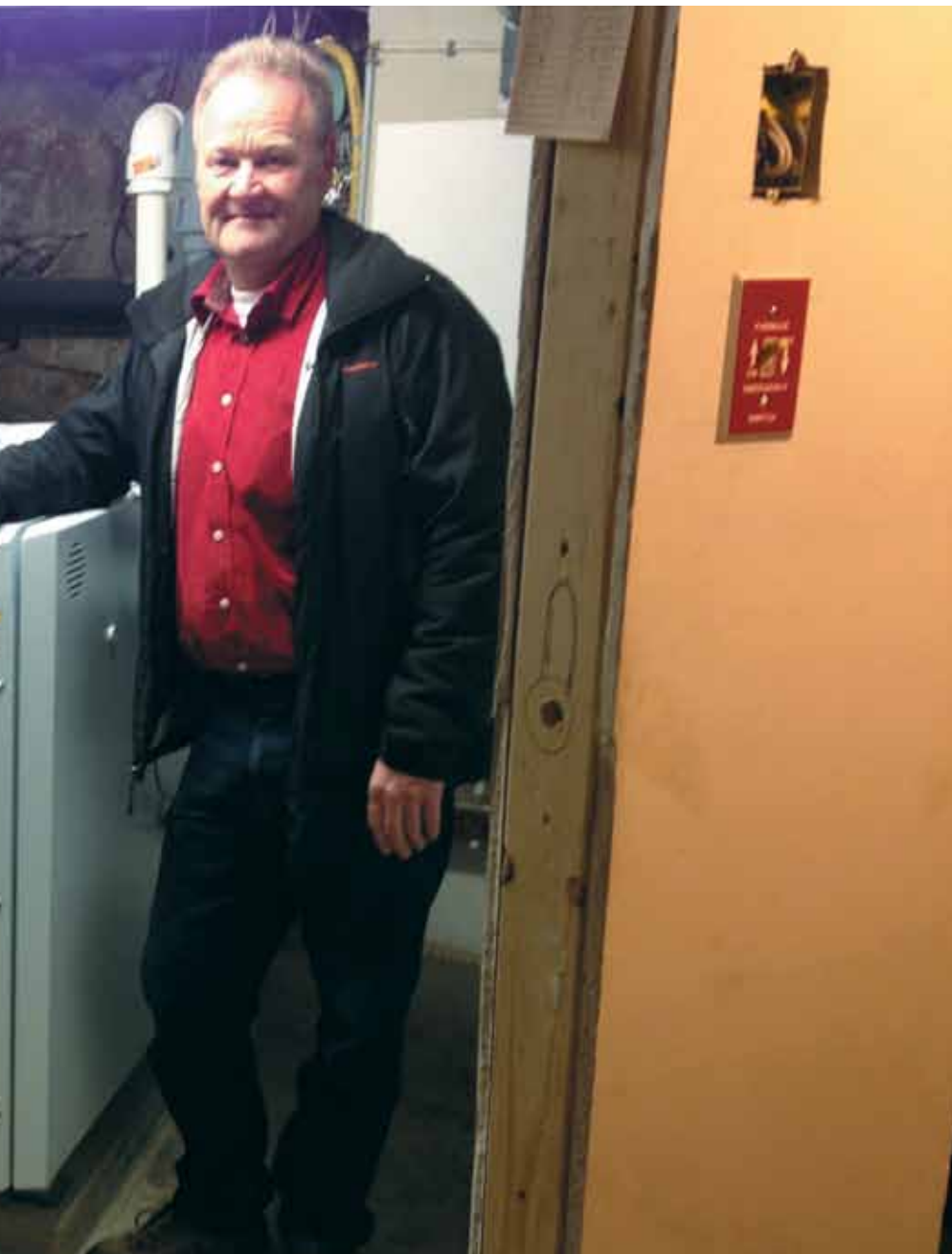
Unité de cogénération alimentée au propane installée à l'auberge Smugglers Cove Inn à Lunenburg, en Nouvelle-Écosse
